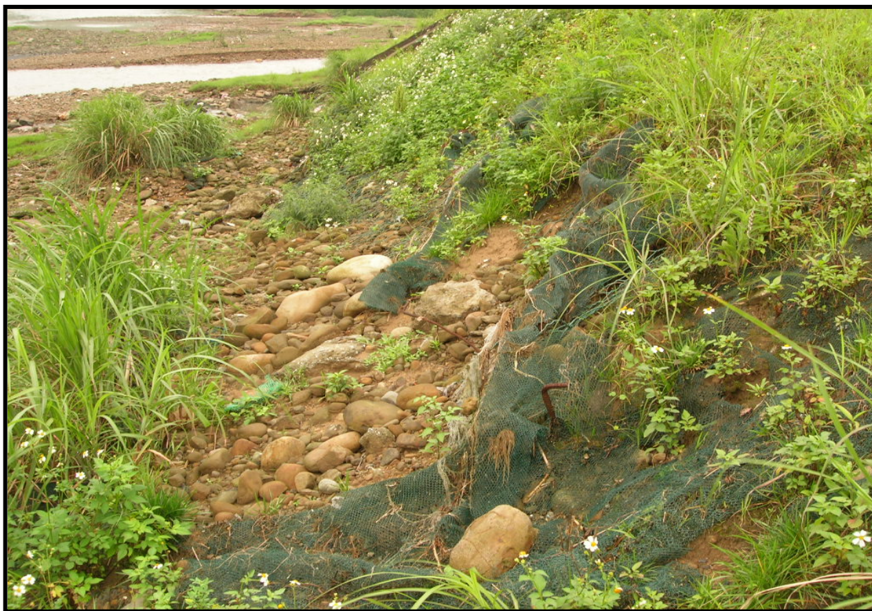
保長坑溪出口石籠損壞
