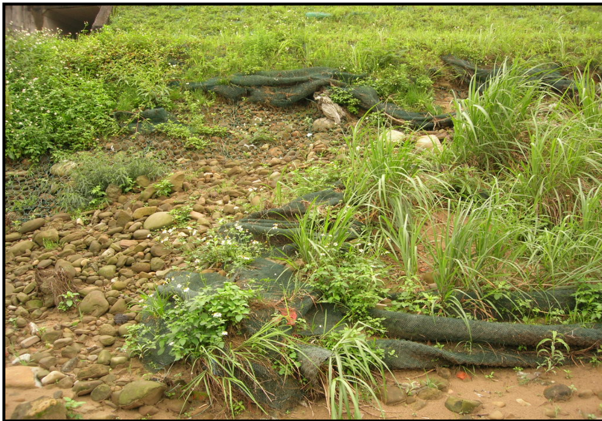
保長坑溪出口石籠損壞
