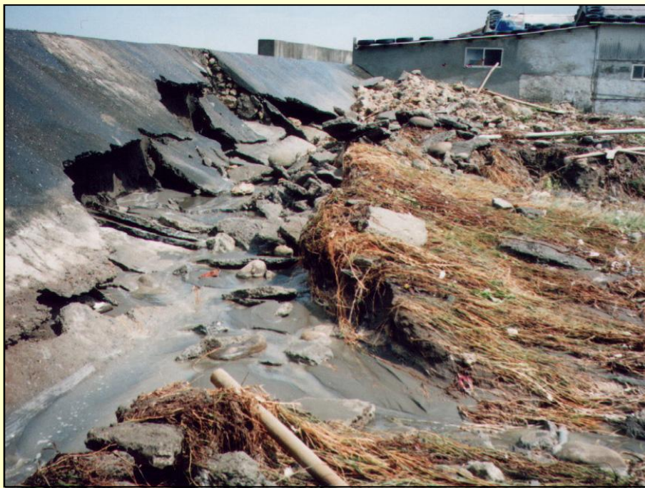
高雄縣茄萣海堤堤內損毀情形
