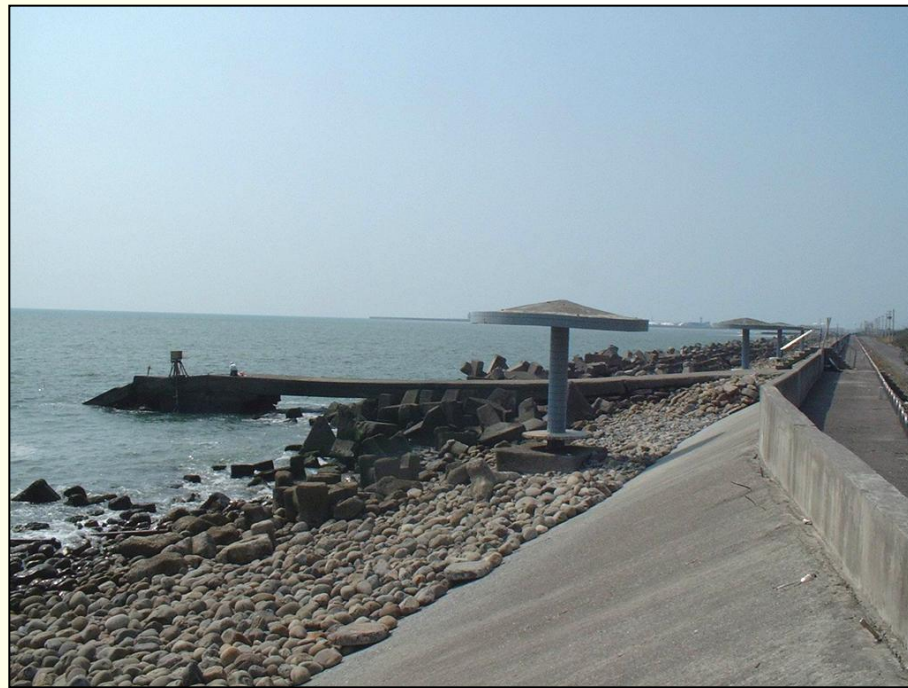
高雄縣彌陀海岸侵蝕情形
